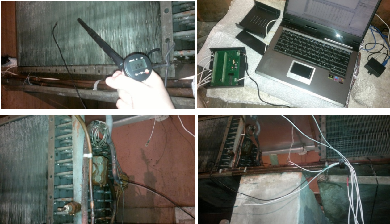
Рис. 4.22. Випробування SCADA енергоефективного керування температурно-вологісними режимами при холодильному зберіганні рослинної продукції в холодильній камері дослідного господарства "Мелітопольське".
