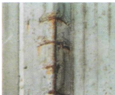
Рисунок 2 - Корозія арматури в наслідок недопустимо тонкого захисного шару бетону.
