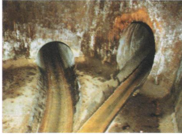
Рисунок 3 - Приклад хімічної корозії бетону: сульфатне розбухання.
