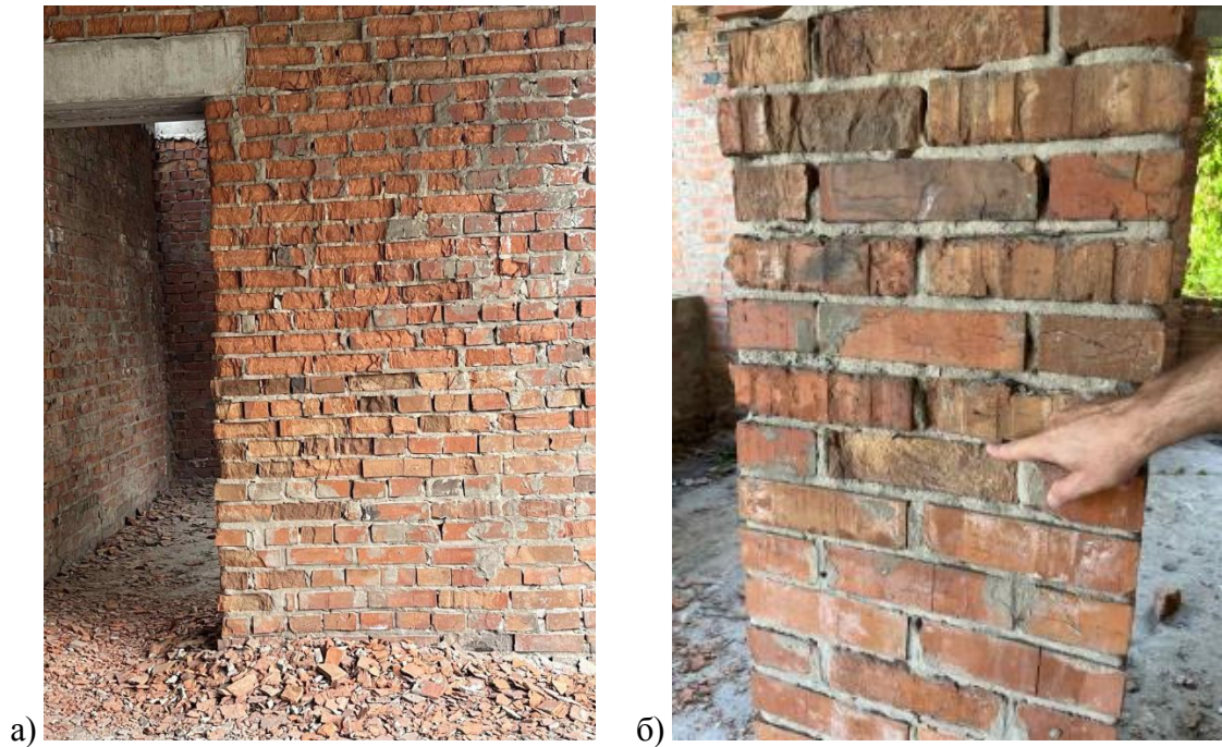
Рисунок 1 (а; б) – Морозобійне руйнування, вимивання швів цегляної кладки
