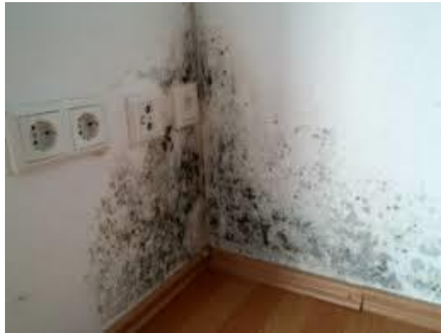
Рисунок 1 – Зволоження стін в наслідок поганої вентиляції
