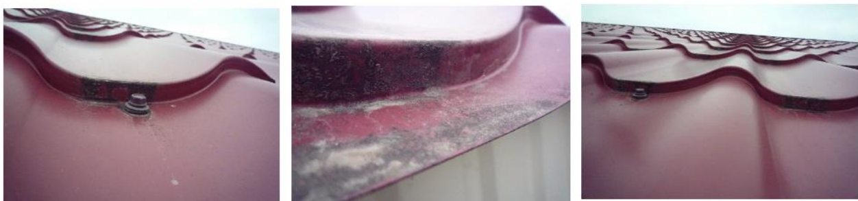
Рисунок 2 - Натурний експеримент по візуальному встановленню технічного стану холодної покрівлі з металочерепиці кольору RAL 3011
