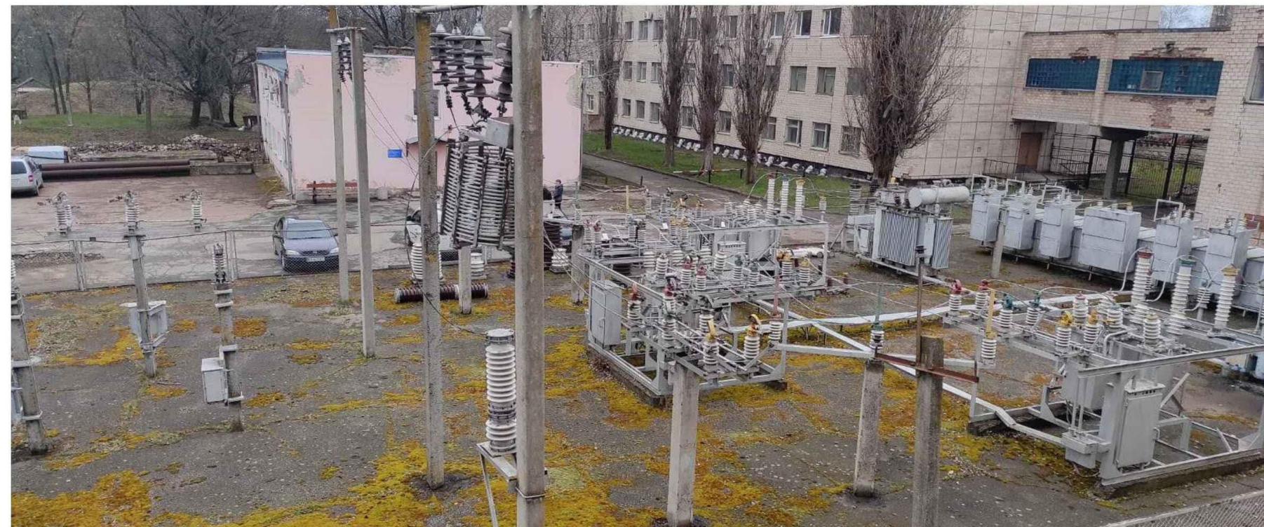
Навчальний полігон – підстанція КТПБ-35/10 кВ
